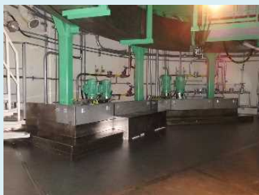
導入された コリウムシールド
